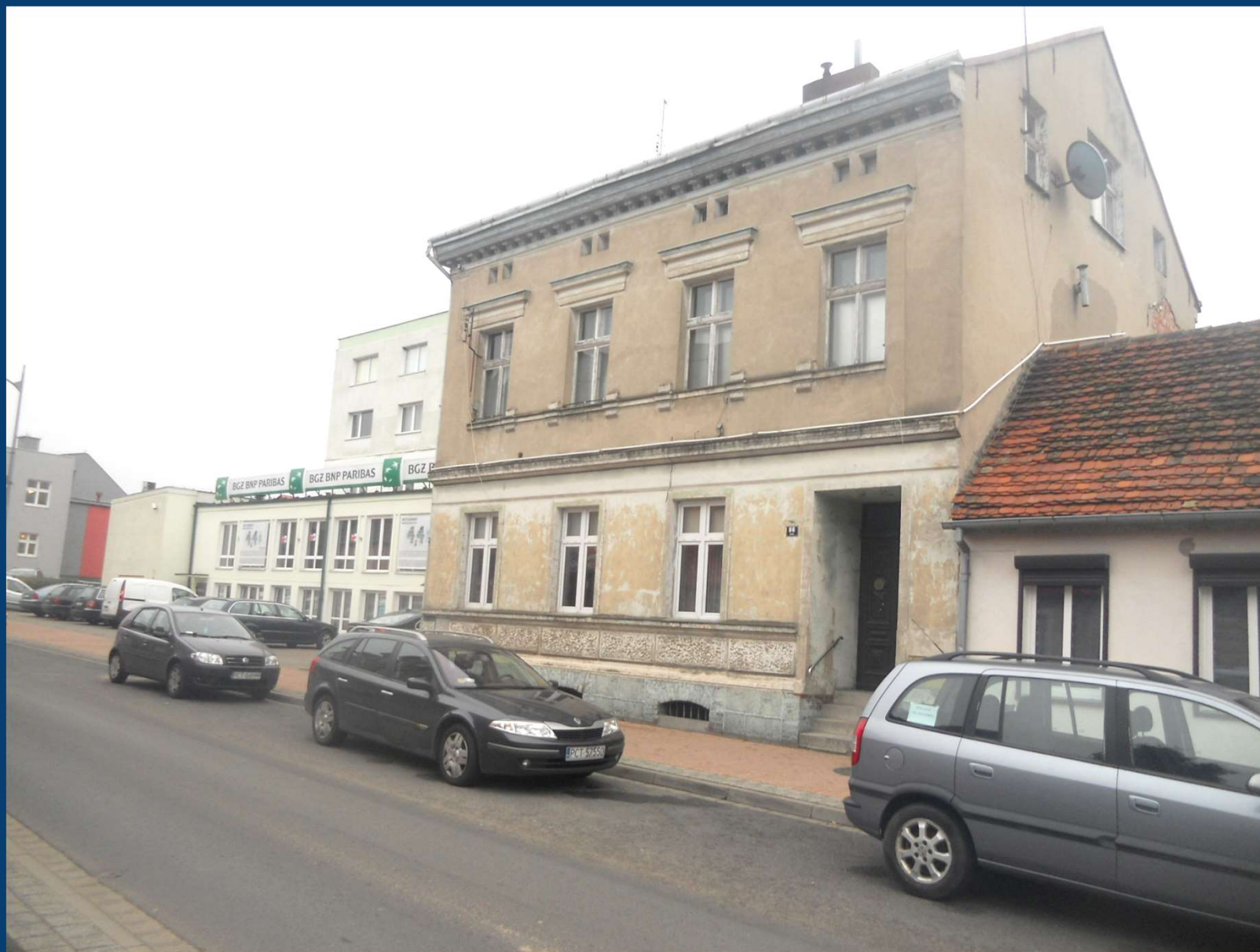
Kościuszki 66 – okna przed wymianą – 1 piętro
